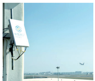
保山云瑞机场塔台布设的5G-A通感基站。杜忠恒 摄
